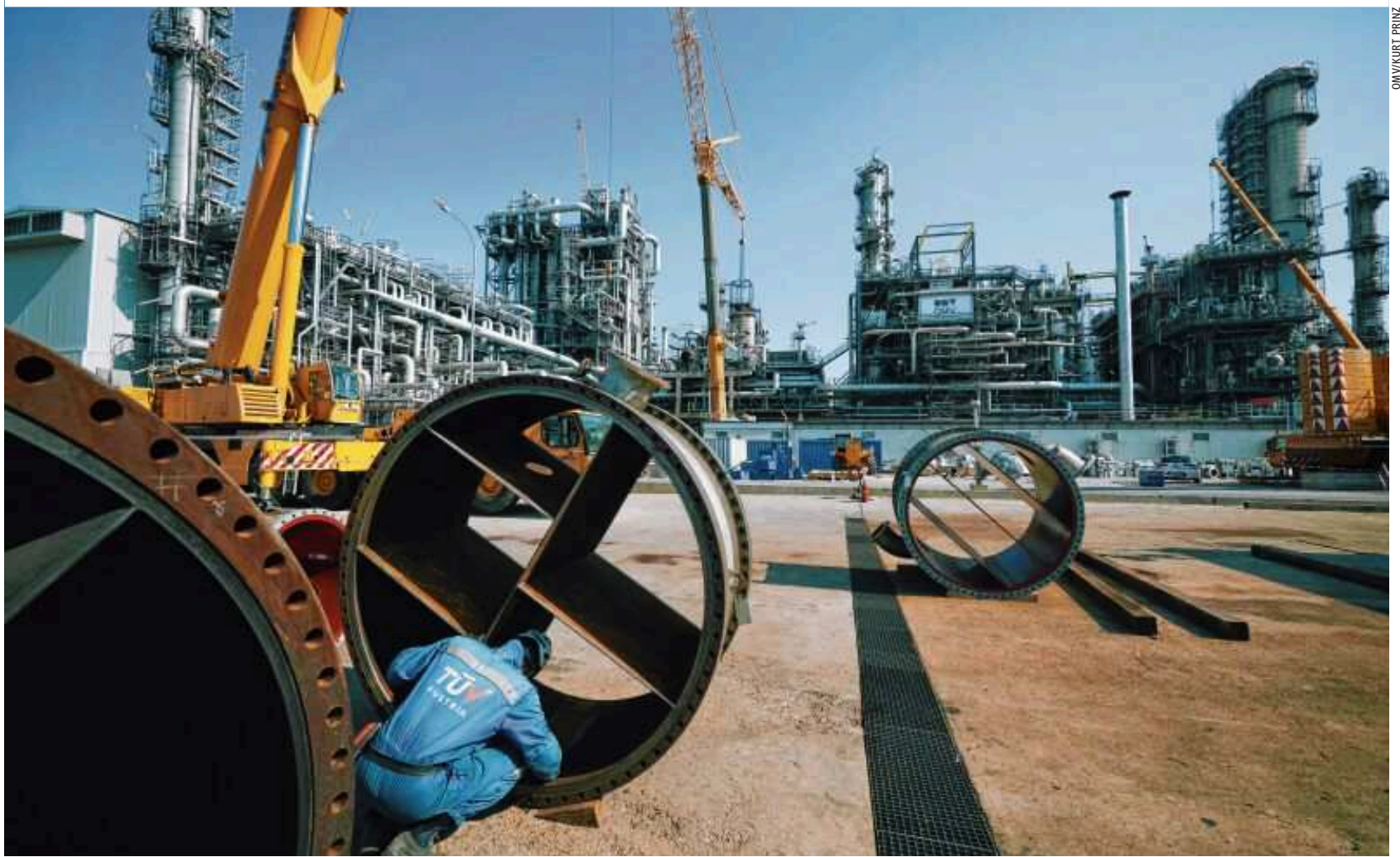
Ein TÜV AUSTRIA Prüftechniker bei der gesetzlich vorgeschriebenen Generalinspektion des petrochemischen Teils der Raffinerie Schwechat
